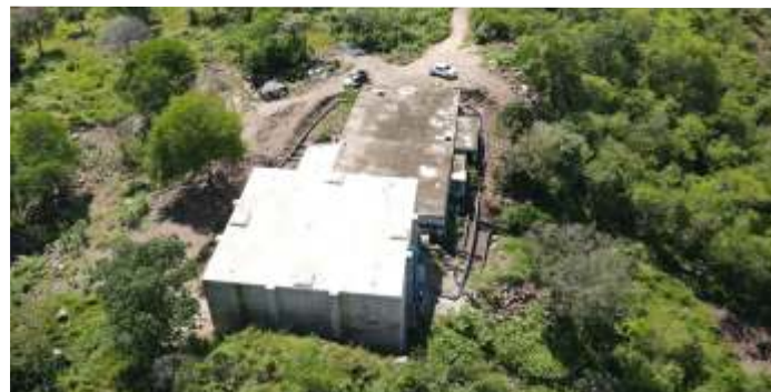
El nuevo tanque de almacenamiento de Bosconia, construido dentro del proyecto fase 1 de la optimización del acueducto urbano, tiene una capacidad de almacenamiento de 2.000 mt. cúbicos.
