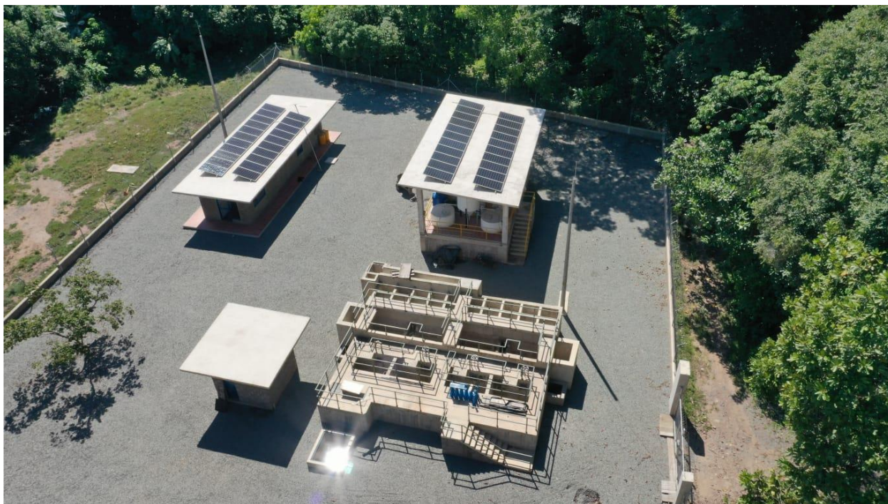
Planta de Tratamiento de Agua Potable.
