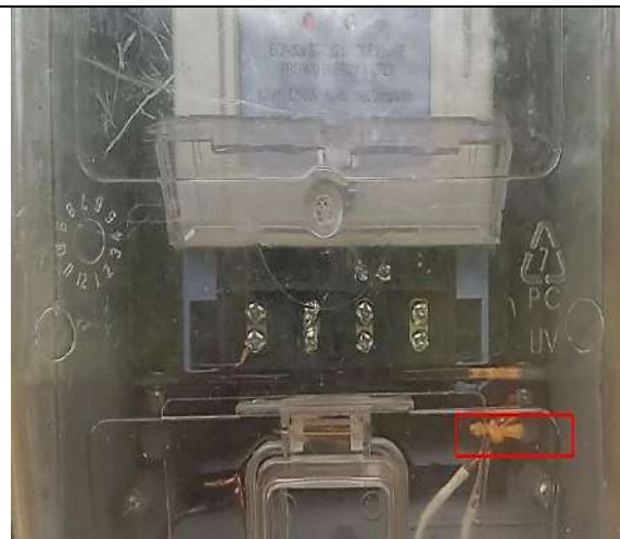
Imagen 45. Manipulación conexiones del medidor.
