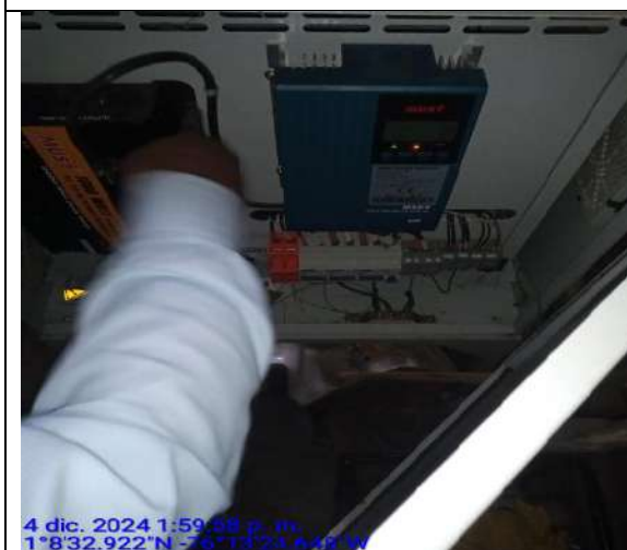
Imagen 46. Fallas en el Inversor.
