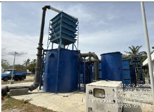
Imagen 79 Torre de aireación y tanque de aireamiento.
