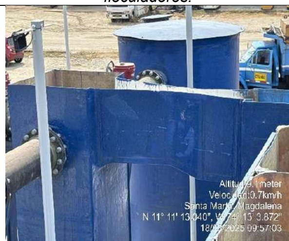
Imagen 83 Vista general PTAP - Canaleta Parshall.
