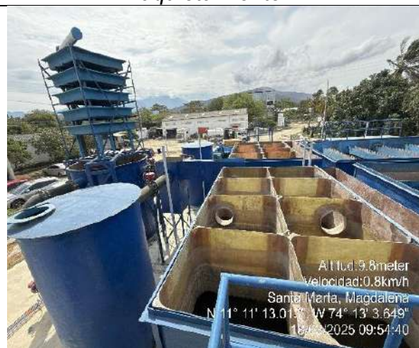
Imagen 81 Vista general PTAP - floculadores.
