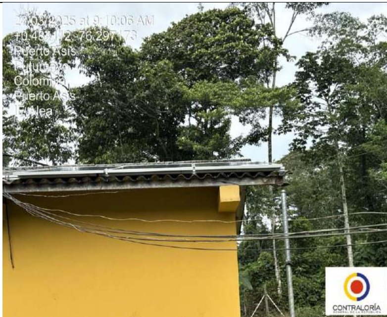
Imagen 135. Cables sin el respectivo aislamiento, incumpliendo normatividad RETIE y NTC2050 y 4552
