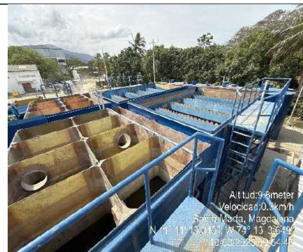
Imagen 82 Vista general PTAP - floculadores y sedimentadores.
