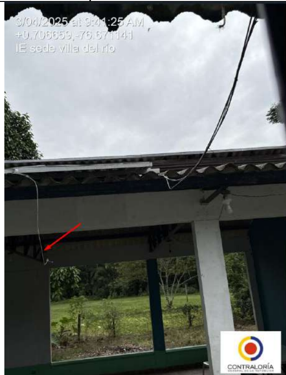
Imagen 134. Cables sueltos incumpliendo normatividad RETIE y NTC2050 y 4552
