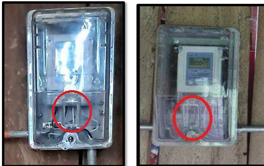
Foto 54. Caja monofásica con pin de corte instalada.
